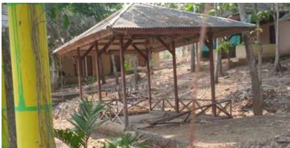
Gambar 5. Fasilitas gazebo/shelter yang terbengkalai di area Telaga Gupit Sumber: Sundalanews.com. (2023, 6 Oktober).
