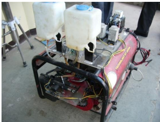
Gambar 1. Genset dengan Perangkat Pengatur Bahan Bakar dan Bukaank Choke
