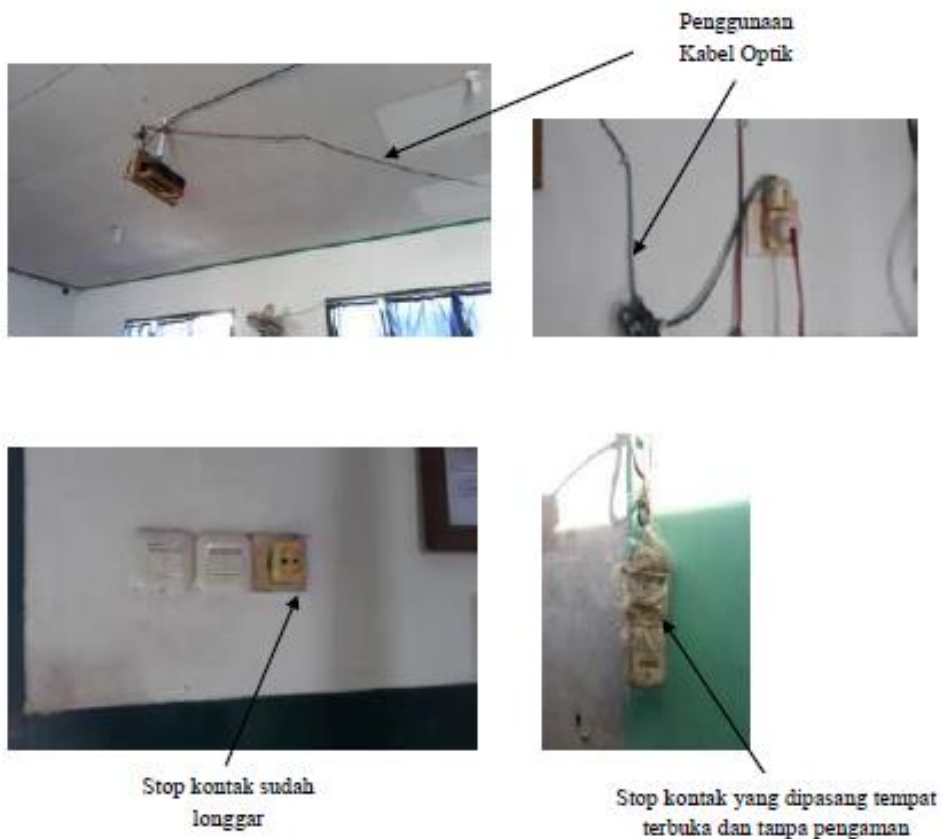
Gambar 5. Contoh Peralatan dan Instalasi Listrik yang Terpasang
