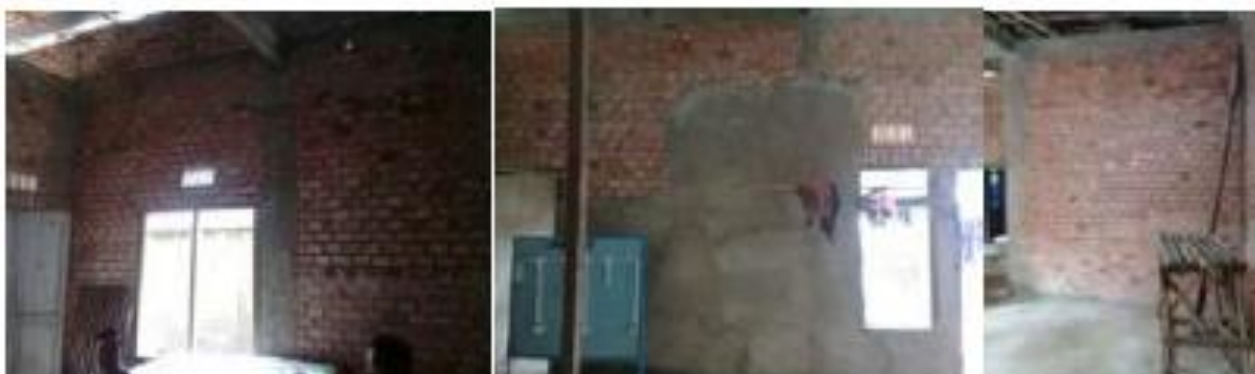
Gambar 7. Rumah salah satu warga RW. 01 Kel. 36 Ilir yang Instalasi Listrik belum terpasang
