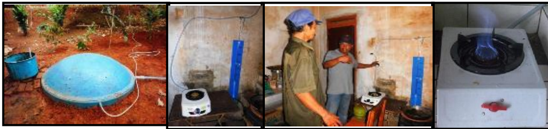
Gambar 8. Instalasi biogas di dapur rumah
