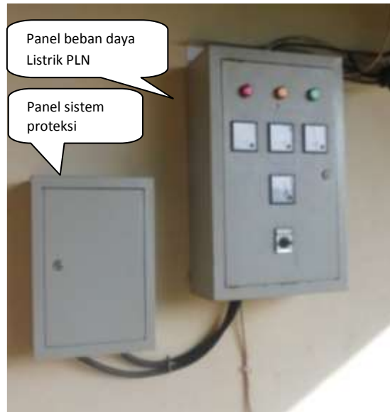
Gambar 5. Penggabungan panel sistem proteksi dan panel beban daya listrik PLN
